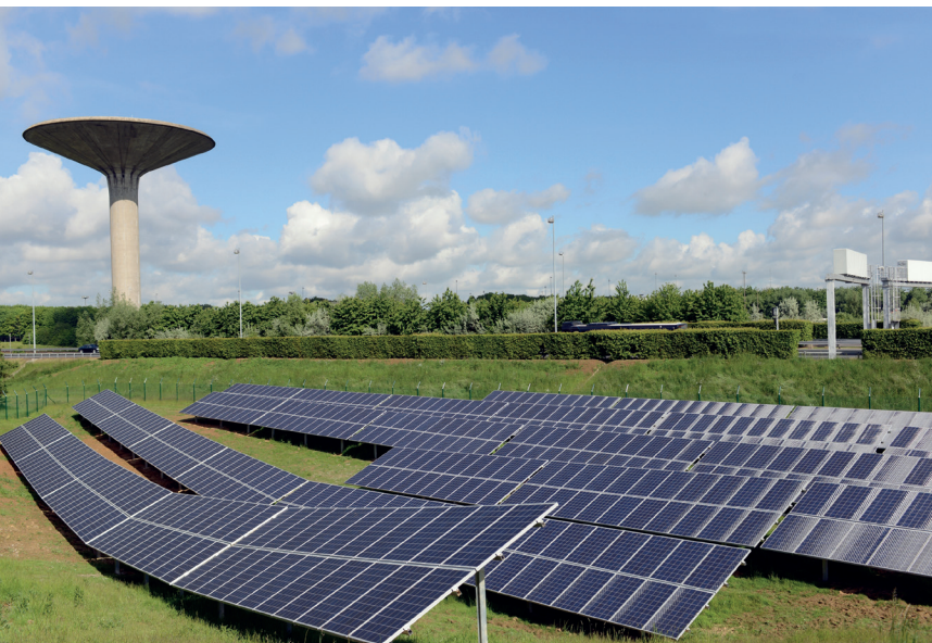
Ferme photovoltaïque à l'aéroport Paris-Charles de Gaulle. ©JM Jouanneux, Groupe ADP
