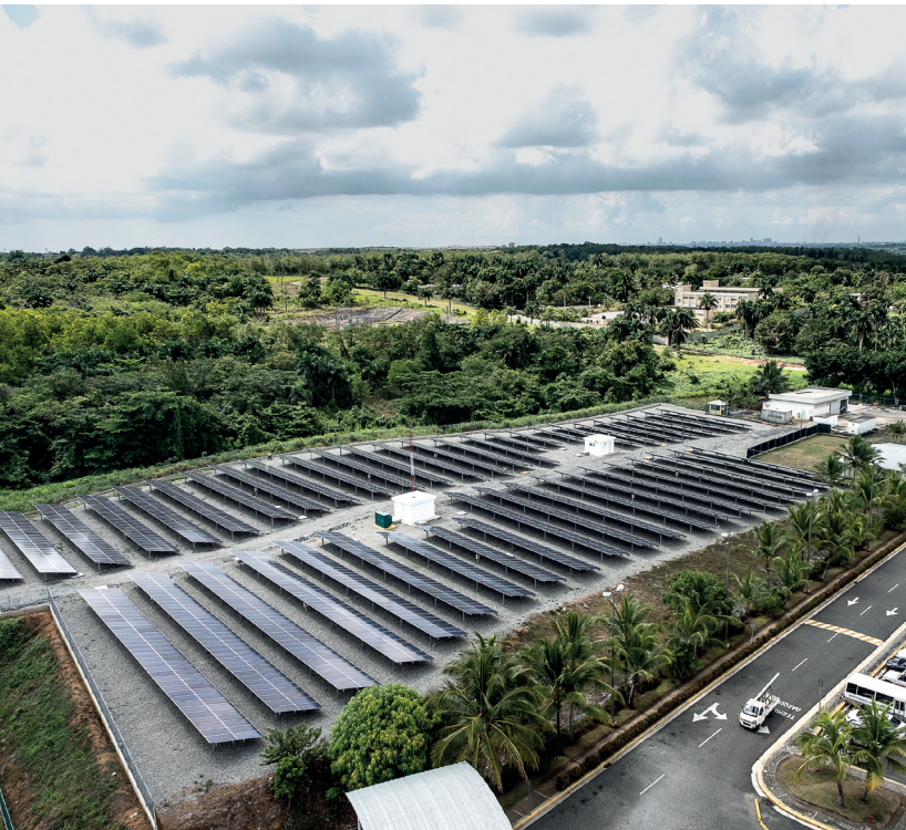
Panneaux solaires - Aéroport de République dominicaine. © GOVIN SOREL.
